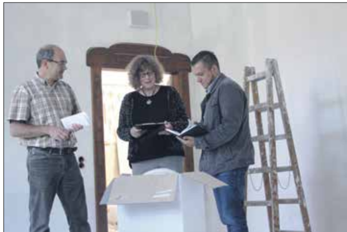
Schulleiter Thomas Müller, Architektin Uta Jahn und Mario Böttger vom Bauamt des Landratsamtes (v. l.) bei Absprachen zum weiteren Arbeitsablauf. Zum Schulbeginn am 10. August soll das Bio-Fachkabinett komplett fertig sein.
