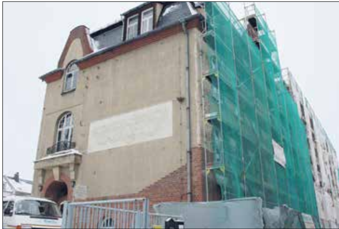
Noch präsentiert sich das Schulgebäude eingehüllt und im tristen Baustellencharme. Zu Beginn des neuen Schuljahres sollen die Irchwitz Kinder hier wieder lernen können.
