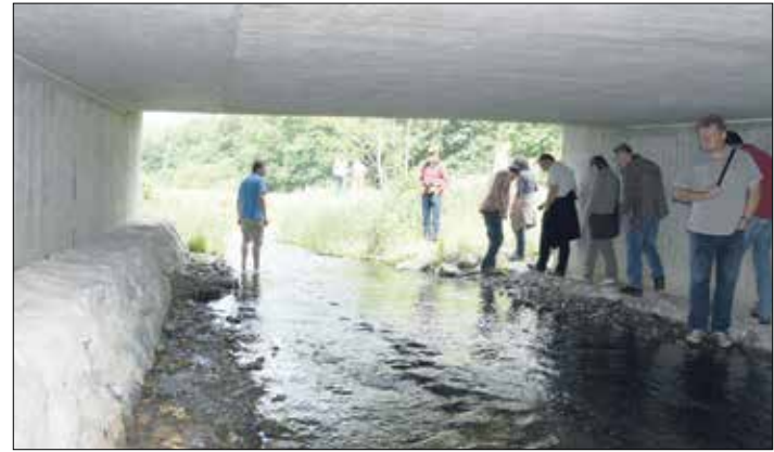
Die Querungshilfen für Fischotter unterhalb der Brücke über den Pöltzschbach nahe Untergeißendorf.
